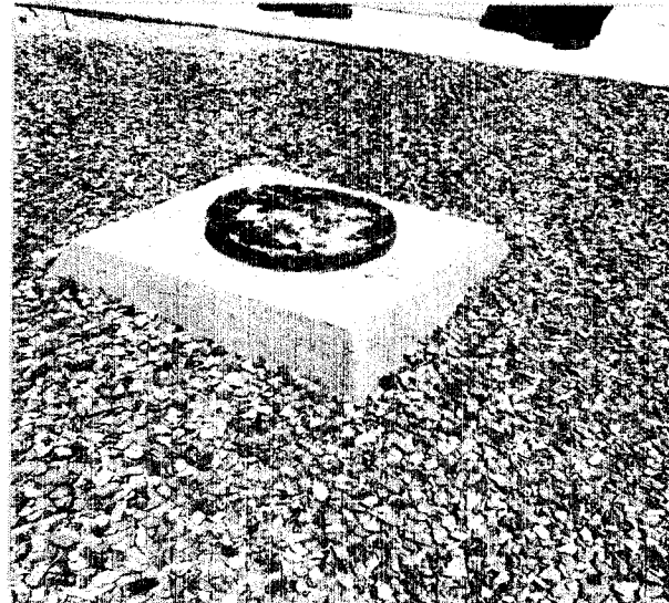
BROCAL SIN EQUIPO DE BOMBEO
