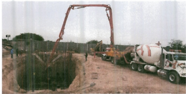
COLADO EN PTAR CERROGORDO
